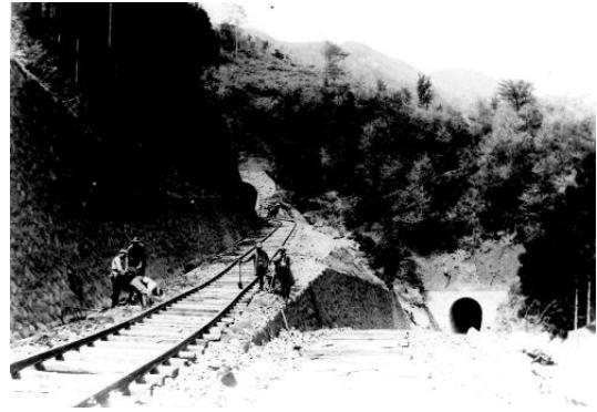
出山信号場付近建設工事 【下田組提供】
