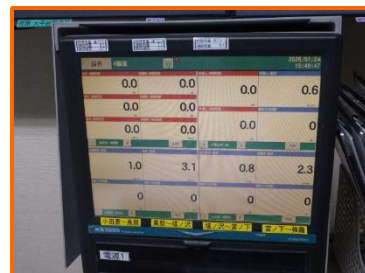
風速・雨量監視モニター
