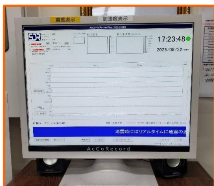
【デジタル地震監視システム】
