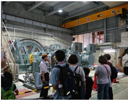
普段は入れない場所で ケーブルカーを動かす装置を間近で見学！
