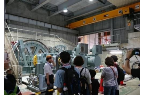
ケーブルカー運転設備
